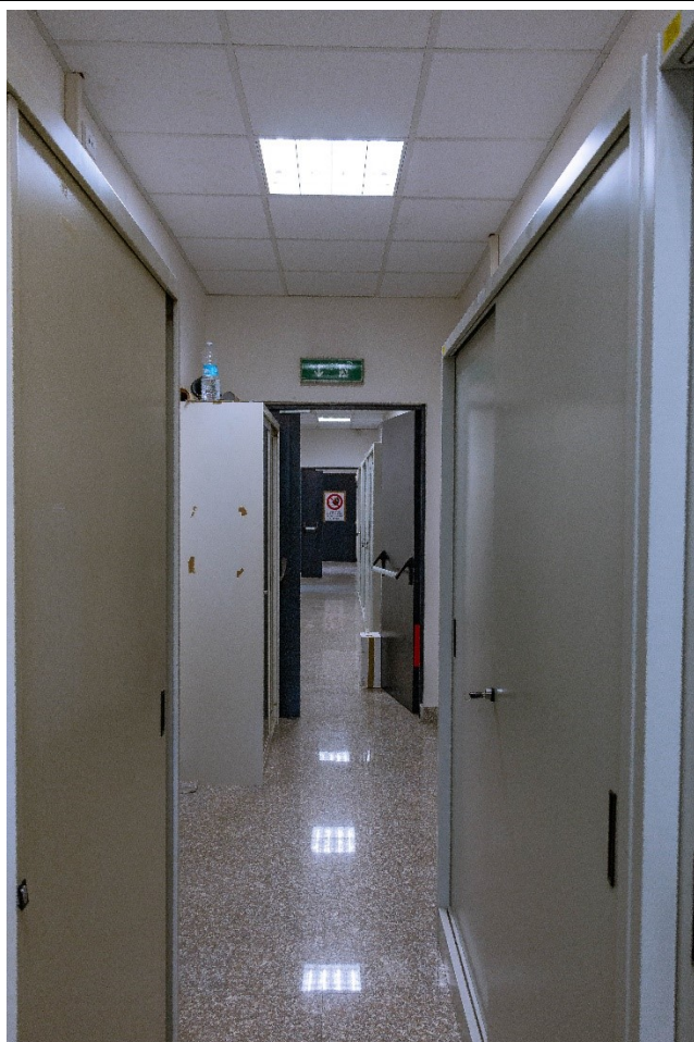
Foto 35. Zona archivi piano secondo indicazioni e apparecchi indicanti le vie di esodo solo per alcune zone.
