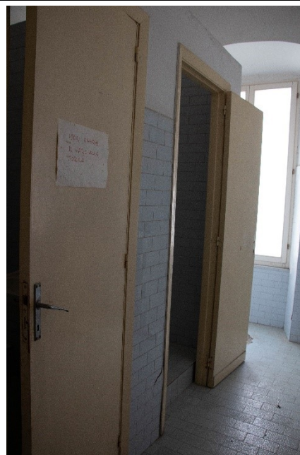
Foto 14. Blocco Servizi igienici piano secondo da ristrutturare
